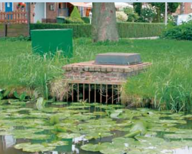
Een riooloverstort is niet altijd goed te herkennen
